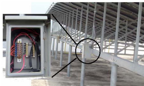
รูปที่ 4 กล่องต่อสายแสงไดโอดกันกระแส
