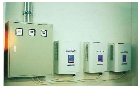
รูปที่ 9 การติดตั้งอินเวอร์เตอร์และตู้มิเตอร์แสดงผลการผลิตไฟฟ้า
