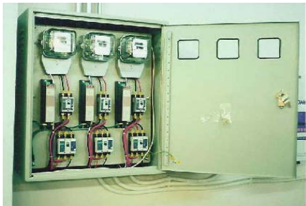
รูปที่ 6 แสดงเครื่องวัดกิโลวัตต์ชั่วโมงและ อุปกรณ์ป้องกันระบบฯ
