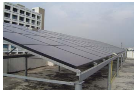
รูปที่ 3 แสดงชุดแผงเซลล์แสงอาทิตย์ จำนวน 84 แผง พิกัดกำลังไฟฟ้า 4,868.64 W
