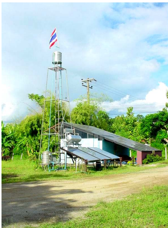
รูปที่ 8 ชุดประกอบระบบปั้มน้ำพลังงานแสงอาทิตย์แบบที่สอง โดยใช้สารไอโซเพนเทน
