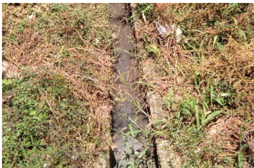
รูปที่ 3 รางคอนกรีตเพื่อระบายน้ำเสียจากฟาร์มสุกร
