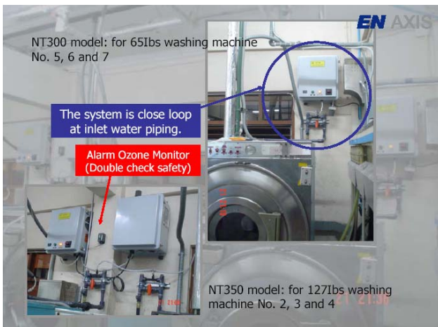
รูปที่ 8 ลักษณะการติดตั้งโอโซน [6]
